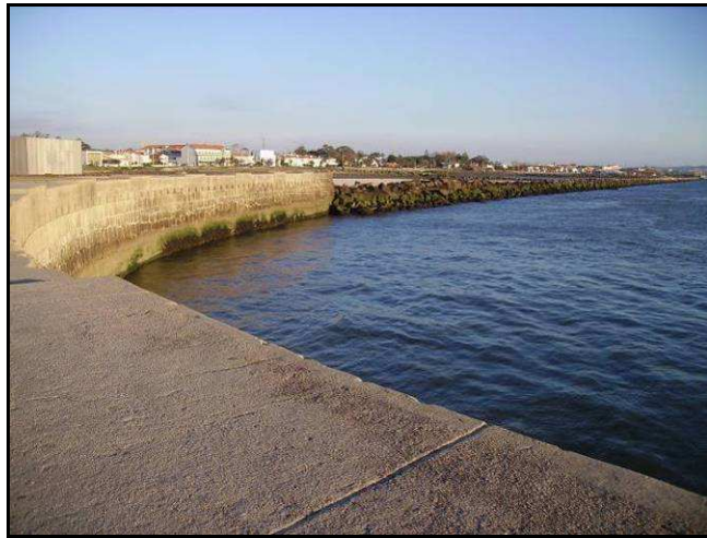
FIG. 43 – Quebra na Margem Direita do Rio Cávado (41°32'31.4" N, 008°47'28.8" W)
