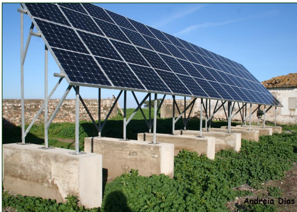
Figura 16 – Fornecimento energético a partir de painéis foto-voltaicos.
