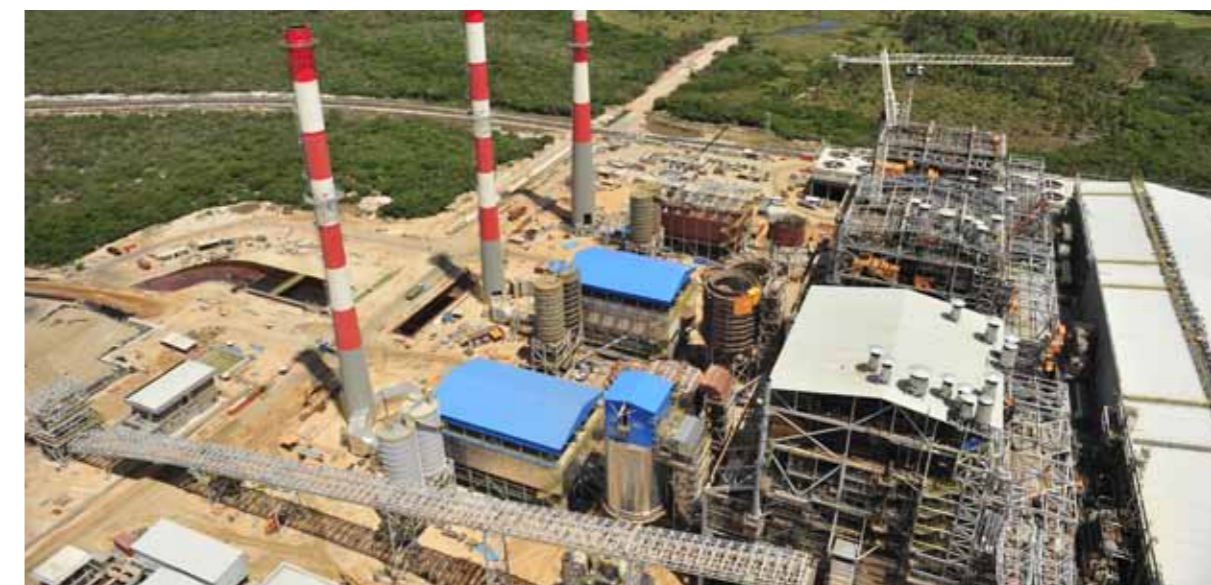
Térmica Energia Pecém - CE
