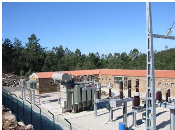
Figura 16 – Aspecto de uma sala de controlo e da subestação
