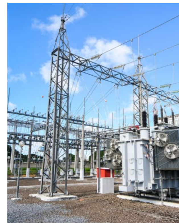
Subestação São Mateus, EDP Espírito Santo
