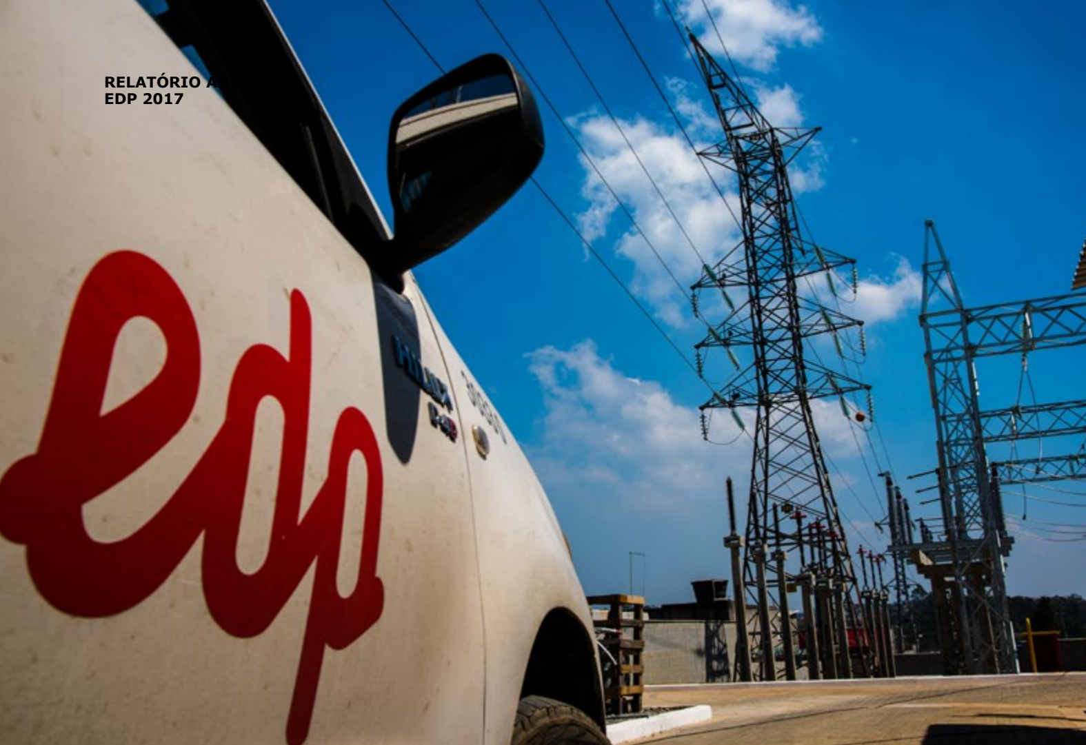
Subestação da EDP São Paulo em Biritiba Mirim
