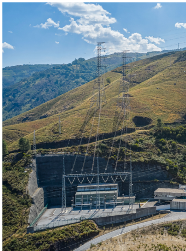
Subestação de Frades II
