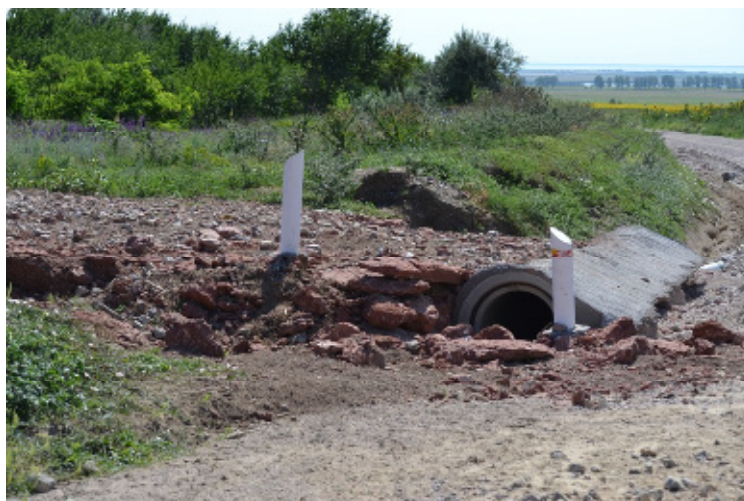
Fig. 41 – drum de acces afectat de ploi
