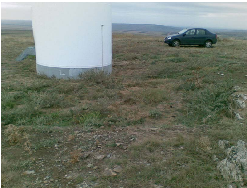
Baza pilonului turbinei Vestas (Topolog - Luminita)
