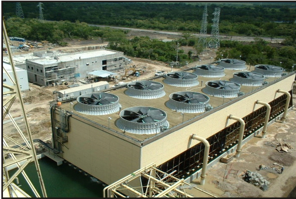
Torres de Refrigeração do Tipo Multicelular
