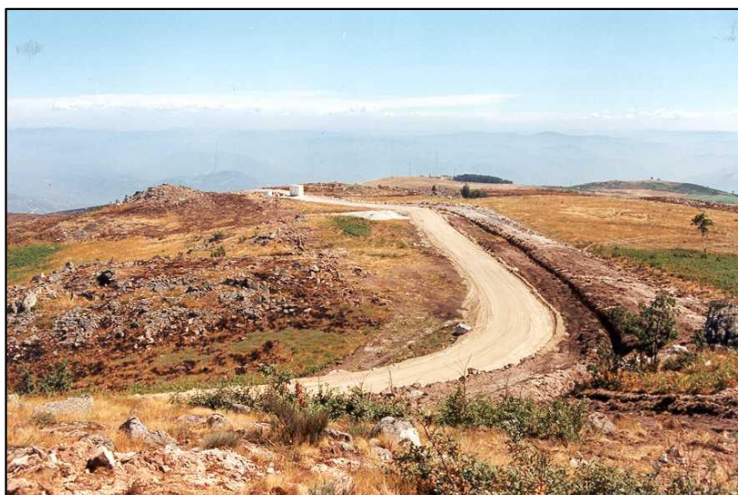
FIG. III. 8 – Vala Para Instalação de Cabo (ao longo da berma direita de acesso)
